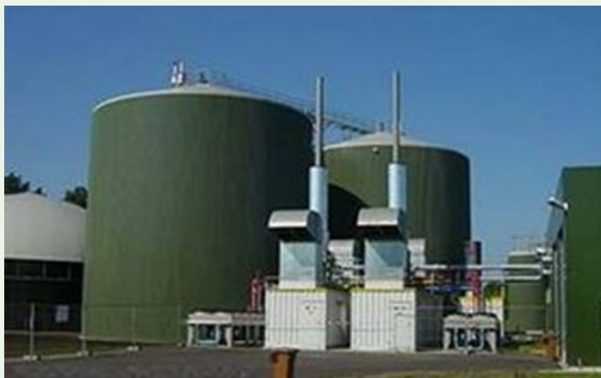
Рисунок 2. – Биогазовая установка, РСДУП «Экспериментальная база “Зазерье”»
